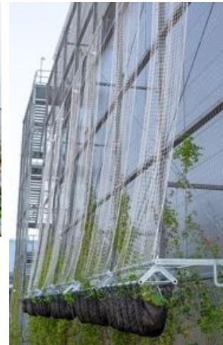
Equinix Germany GmbH Fassadenbegrünung Rechenzentrum
